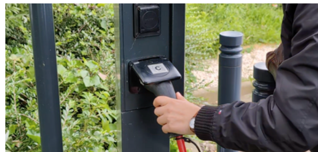
Je le branche côté station
